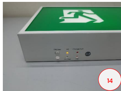
สังเกต LED “AC” ต้องสว่างบ่งบอก ตัวเครื่องได้รับแรงดันไฟฟ้า 220 โวลต์
